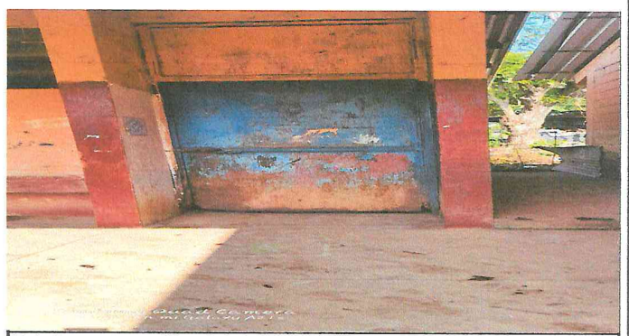
Foto 6: puerta metálica deteriorada antes de la reparación.
